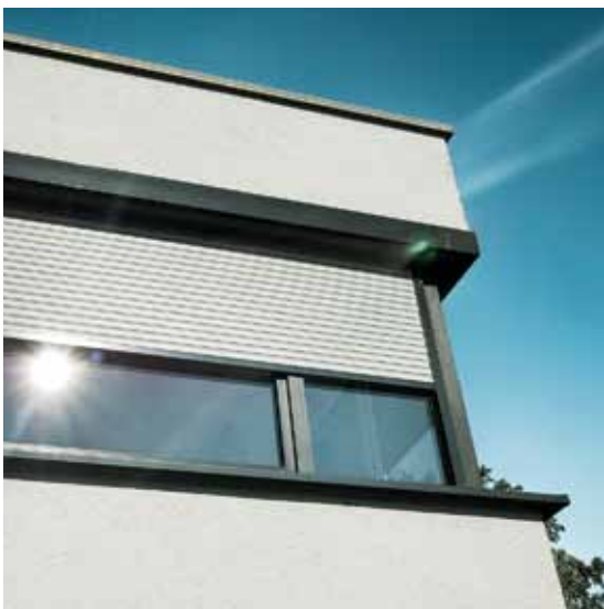
Vorbaurollladen PENTO flächenbündig mit der Fassade montiert.
